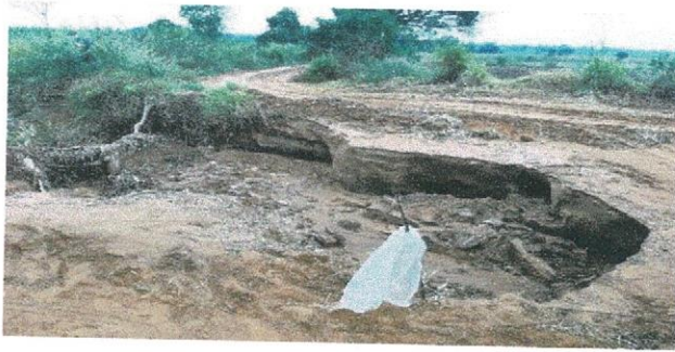
สายนิคมสหกรณ์ข้ามทะเลสาบ ซอย 10 หมู่ที่ 6 บ้านโคกหินเหล็กไฟ
